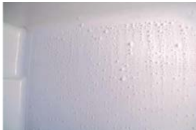
Un refrigerador que funciona bien muestra escarcha en la superficie de los evaporadores.
