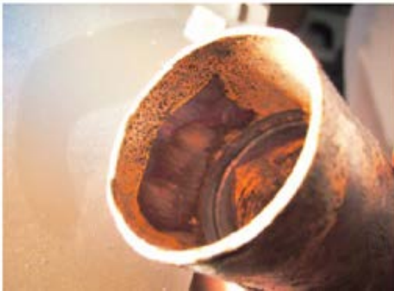
Metal de relleno no penetrado completamente
