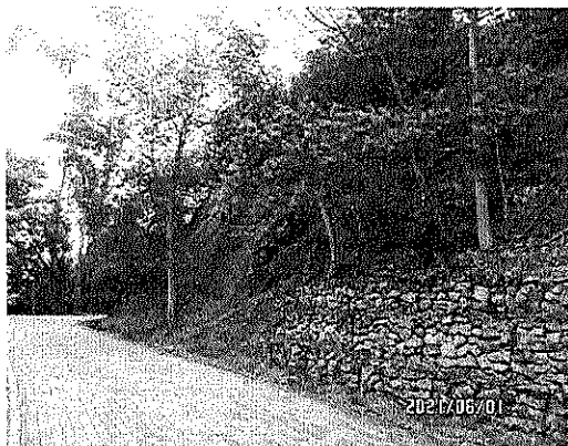
Vía interna dentro de condominio con presencia de vegetación invasora hacia los costados
