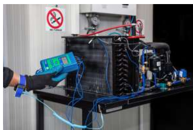
FOTO 116. VERIFICANDO LA TEMPERATURA DEL CONDENSADOR
