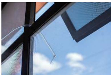
FOTO 119. VENTEO DEL REFRIGERANTE HC
