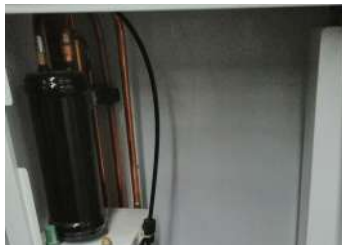
FOTO 9. SISTEMA AUTOCONTENIDO ENFRIADO POR AGUA
