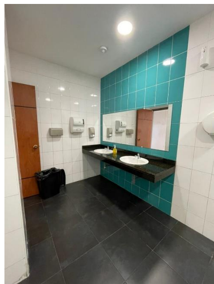
Ilustración 6. Lavamanos, dispensadores, espejo, luminaria
