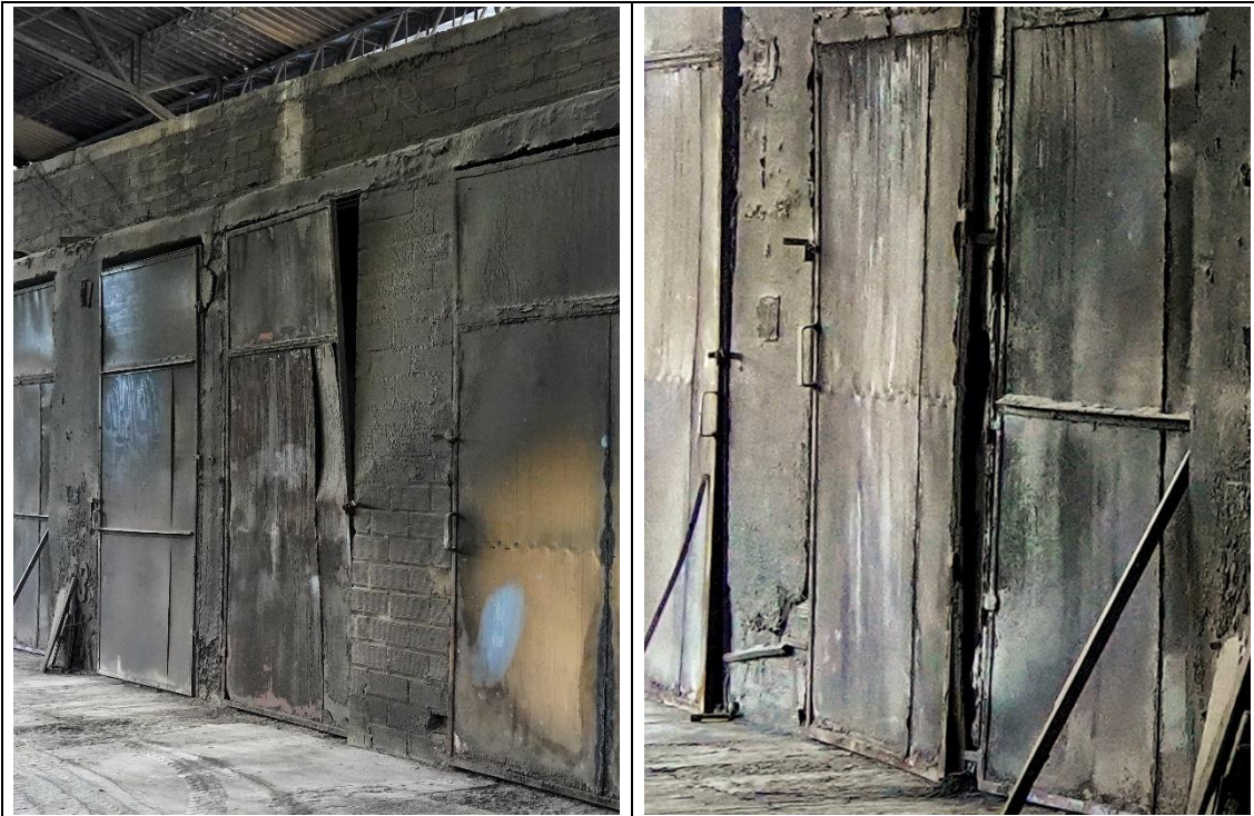
Vista en detalle de puertas que pueden generar mayores emisiones fugitivas.
