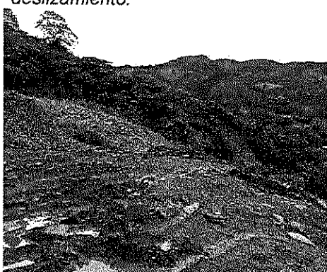
Fotografía 10. Acumulación de agua en zona de escombrera.
