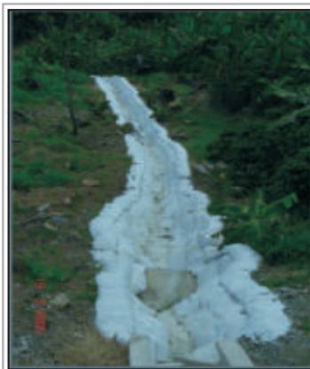
Canal colector de aguas superficiales
