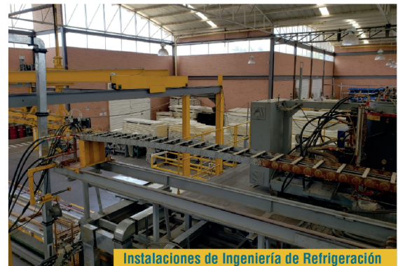
Instalaciones de Ingeniería de Refrigeración Industrial Rojas Hermanos S.A.
