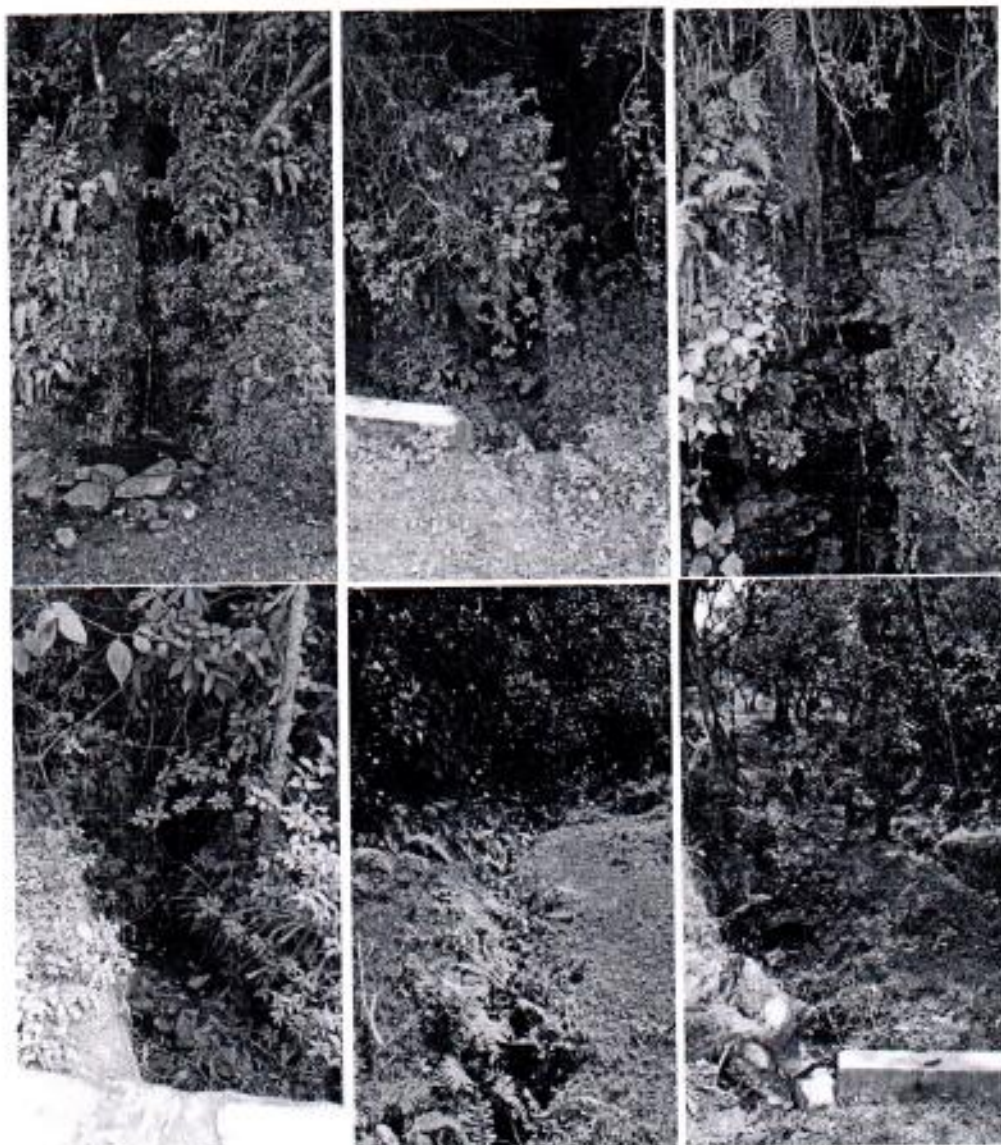
Fotografías 6. Drenajes que son interceptados por el trazado actual de la vía.
